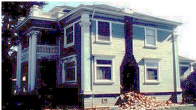
Abb. 2.10.1 > Einsturz eines Kamins
