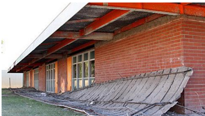
Abb. 2.10.3 und 2.10.4 > Abgelöste Deckenuntersicht und Abplatzungen in Verputz
