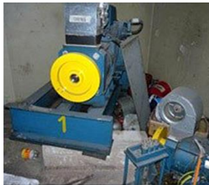
Abb. 2.19.2 > Ungenügend befestigte Antriebseinheit
