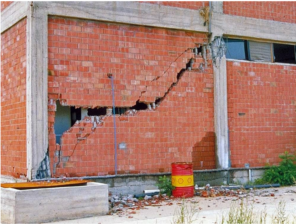
Abb. 1.4 > Schäden an Stützen durch Mauerwerksausfachung, Türkei Erdbeben 1998
