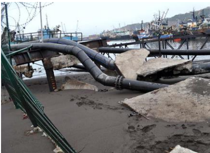
Schäden an Erdölleitungen nach Herabstürzen durch Versagen an den Rohrverbindungen
