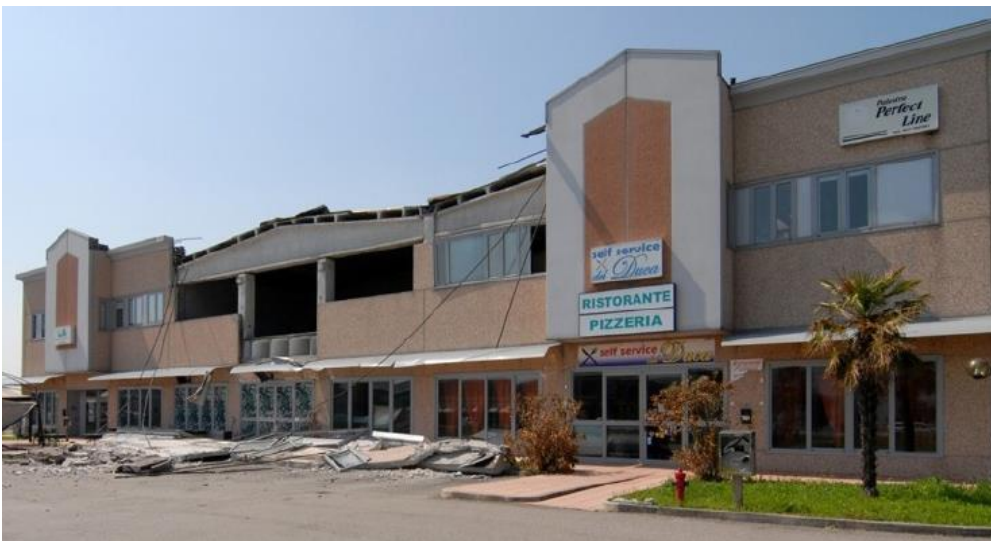
Abb. 1.7 > Herabgefallene Fassade über Terrasse einer Pizzeria, Emilia Romagna 2012
