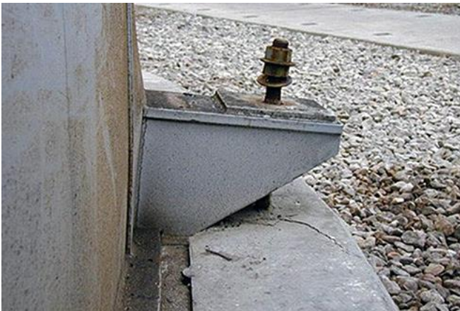
Abb. 2.17.3 &gt; Beschädigte Verankerung
