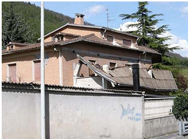
Abb. 2.9.2 &gt; Eingestürztes Vordach
