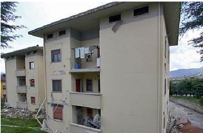
Abb. 2.6.3 > Brüstung im oberen Geschoss herausgefallen
