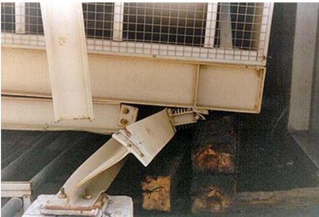
Abb. 2.16.3 und 2.16.4 &gt; Gleitverschiebungen/Instabilitäten
