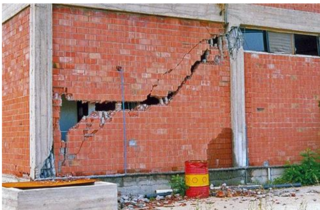
Abb. 2.4.1 > Druckdiagonale durch Mauerwerkswand und Schädigung der Stahlbetonstützen
