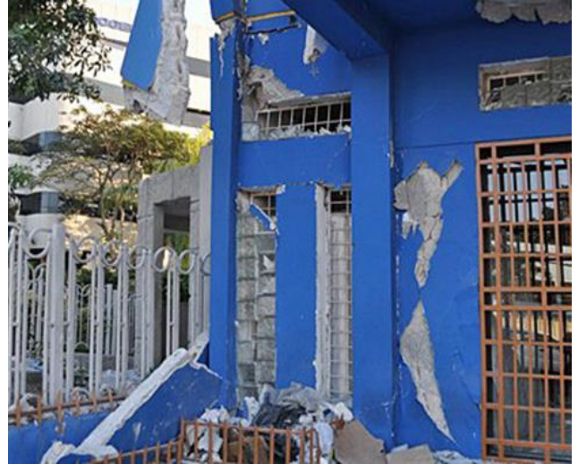
Abb. 2.8.3 > Schäden an Verglasung mit Glasbausteinen
