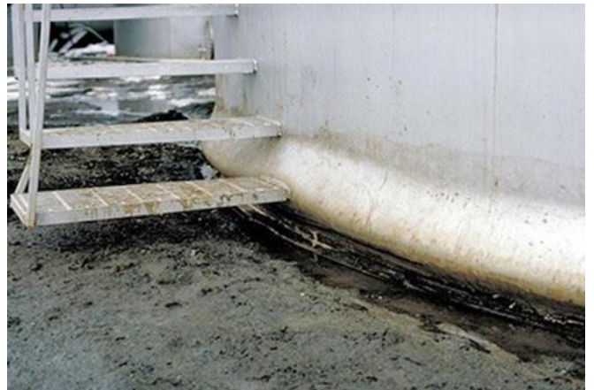
Abb. 2.17.4 &gt; Ausgebeulte Tankwand (sog. «Elefantenfuss»)
