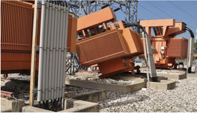
Abb. 2.14.1 &gt; Umgekippte Hochspannungs – Transformatoren
